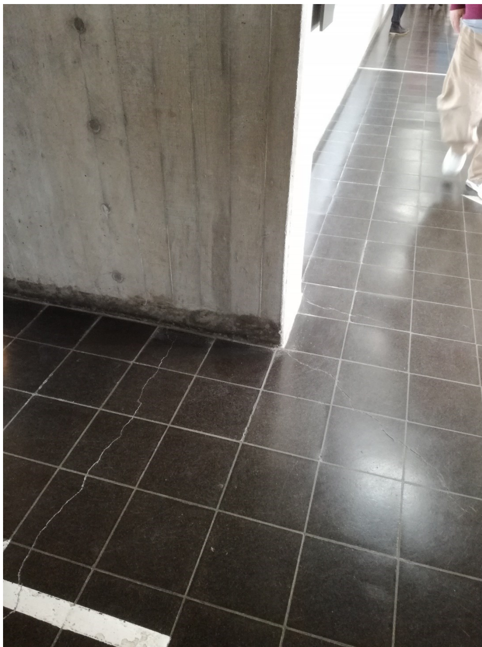
Figur 6.27 Revner i fliser ved søjle ved museumsbutik.
