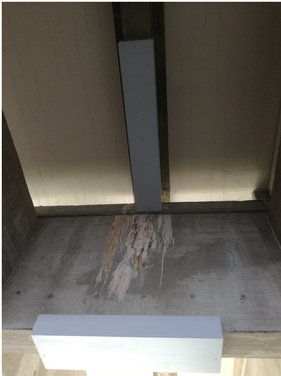
Figur 6.37 Udfældninger grundet fugtindtrængen på indvendige betonkonstruktioner
