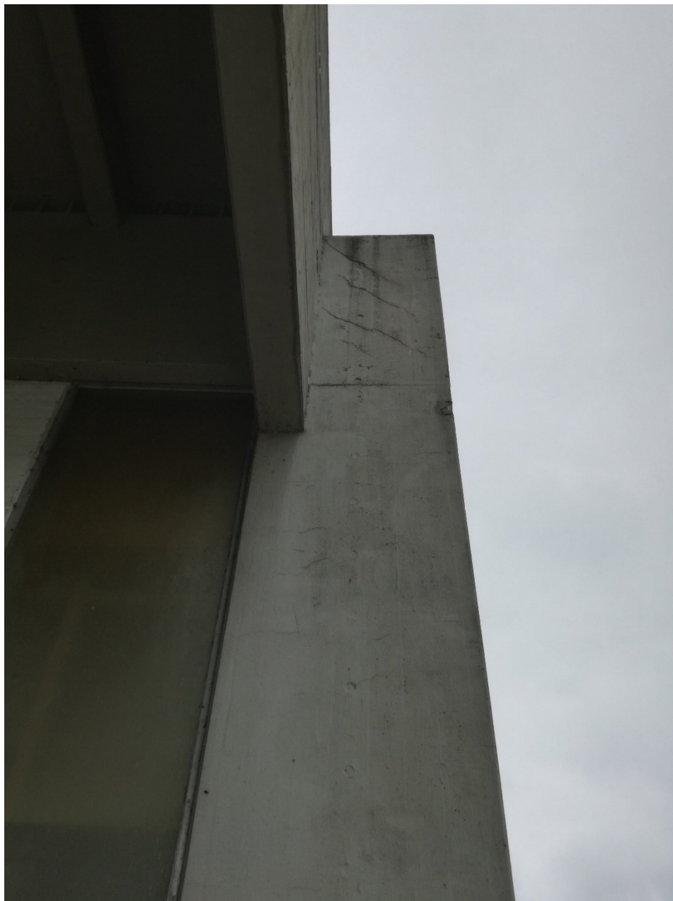
Figur 6.9 Revnedannelse på østfacade øverst på søjle
