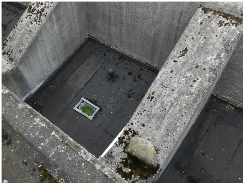
Figur 6.15 Afløb fra tagudhæng på sydfacade
