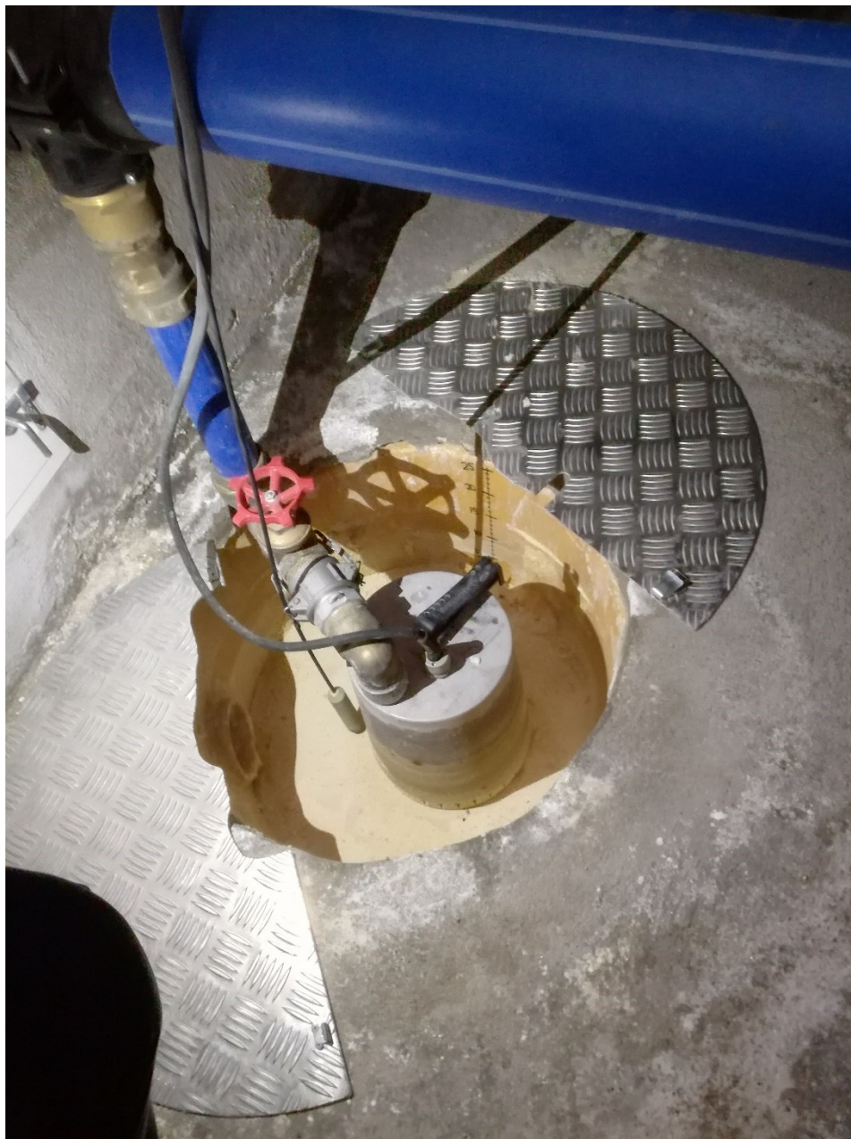
Figur 6.31 Pumpe i krybekælder under udstillingshal.
