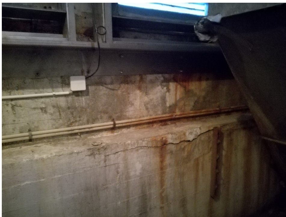
Figur 6.42 Rustudfældninger og tegn på fugtskade indvendigt i kælder på nordfacaden
