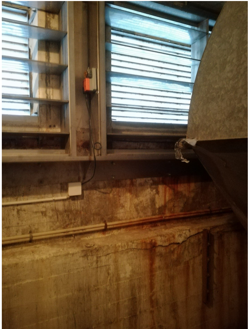
Figur 6.43 Rustudfældninger og tegn på fugtskade indvendigt i kælder på nordfacaden
