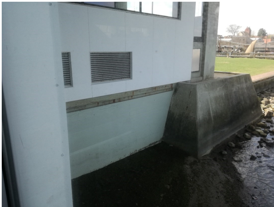
Figur 6.35 Rustudfældninger i dæk på nordfacade
