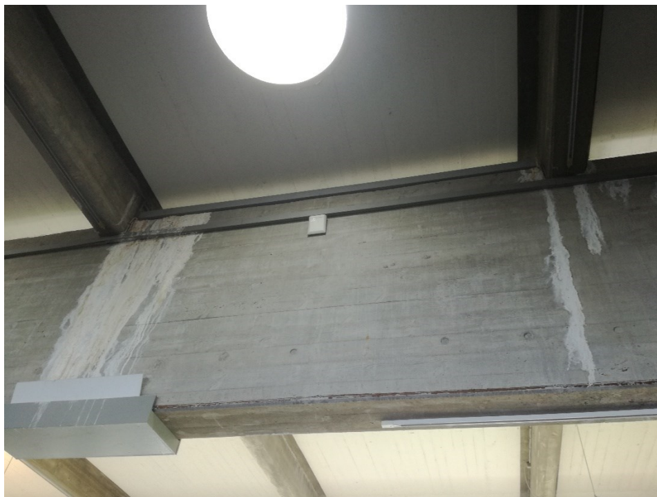
Figur 6.39 Udfældninger på indvendige betonkonstruktioner
