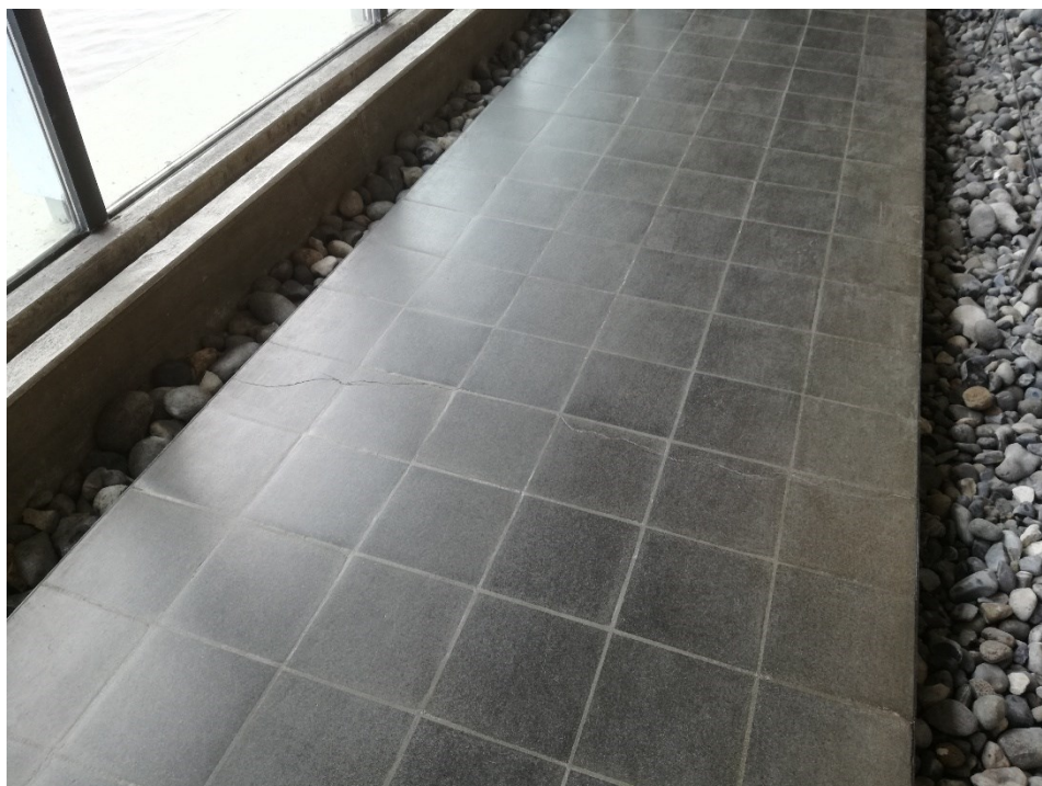
Figur 6.24 Revner i flisebelægning ved nordfacade
