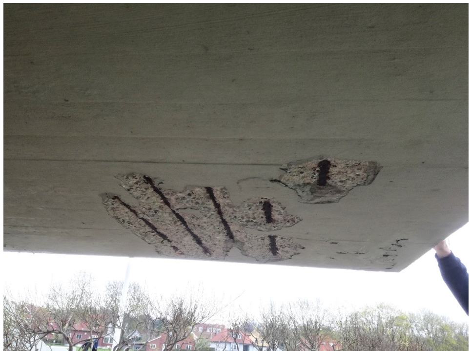
Figur 6.2 Dæklagsafskalninger på underside af platform til indgangsparti
