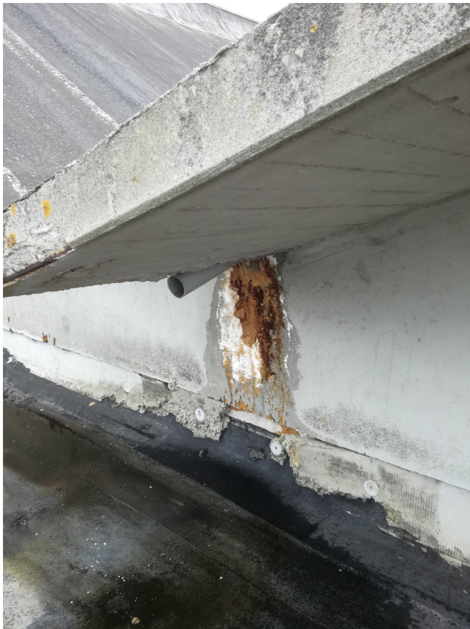
Figur 6.19 Afløb fra taghus på vestfacade. Der ses vandskade ned langs taghusfacade.
