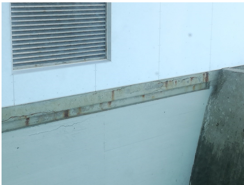
Figur 6.36 Rustudfældninger i dæk på nordfacade
