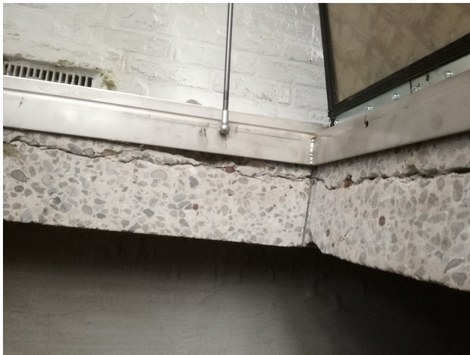
Figur 6.32 Delaminering i dæk ved nedgang til krybekælder ved vestfacade
