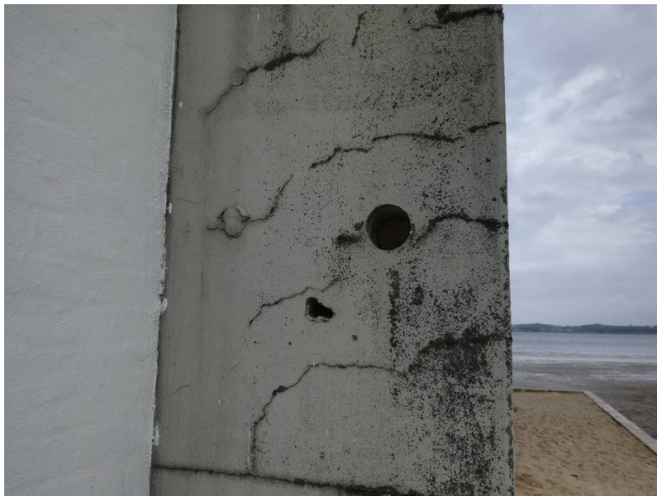
Figur 6.10 Revnedannelse på søjle på østfacade
