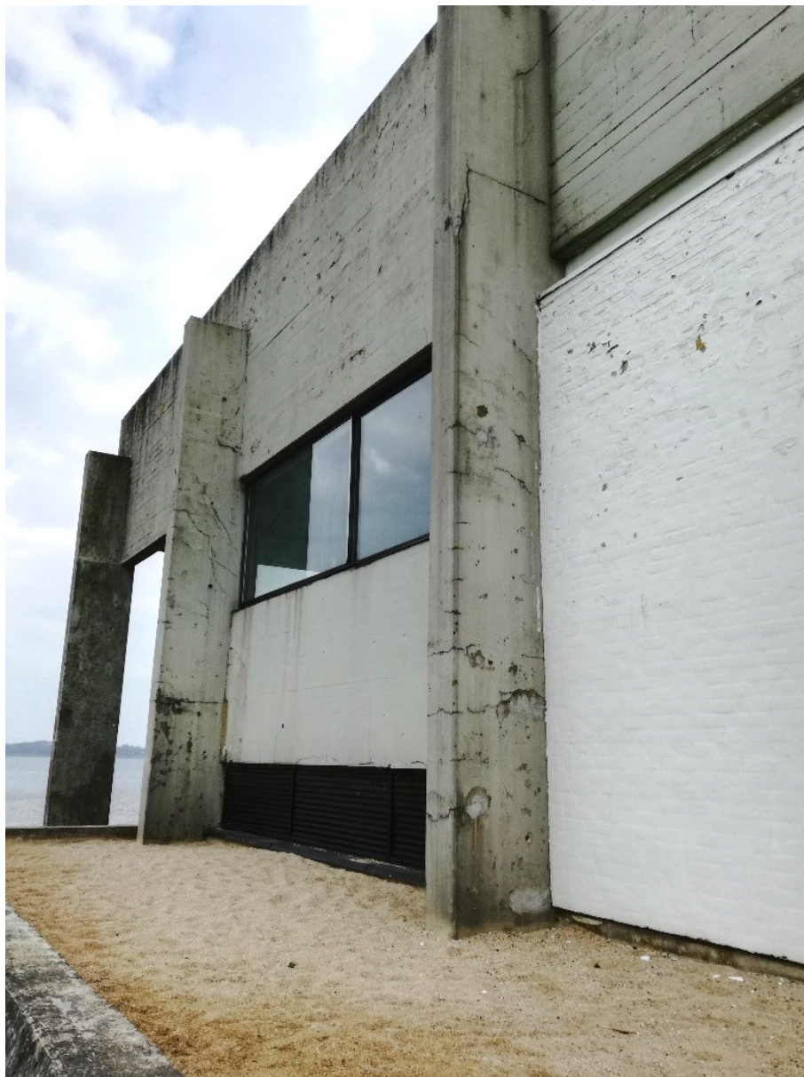
Figur 6.5 Omfattende revnedannelser og tidligere betonreparationer på vestfacade
