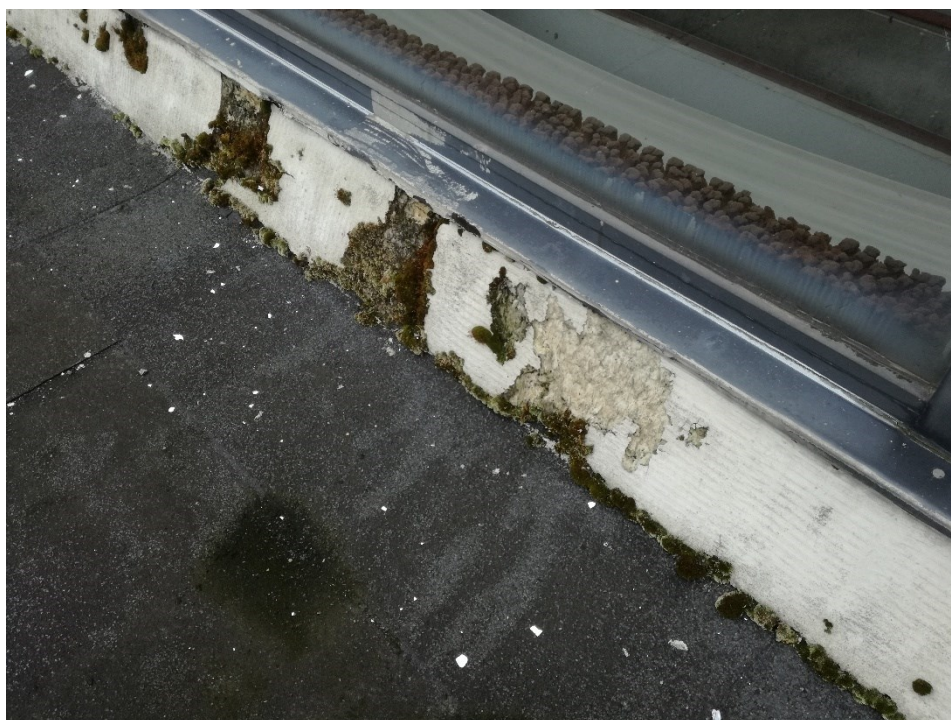
Figur 6.14 Ødelagt isolering på taghuse
