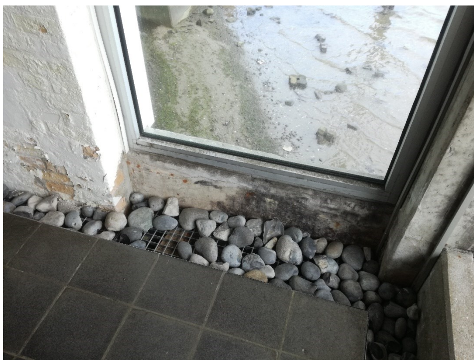
Figur 6.25 Fugtskader og udfældninger på murværk indvendigt på nordvestfacade
