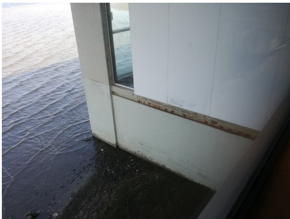
Figur 6.33 Rustudfældninger på dæk udvendigt på vestfacade
