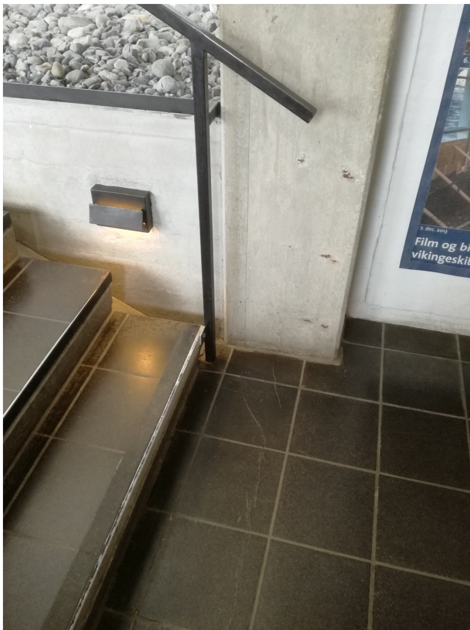
Figur 6.23 Revner i flisebelægning
