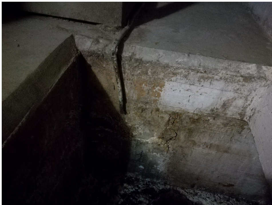
Figur 6.41 Tegn på fugtskader i kælder
